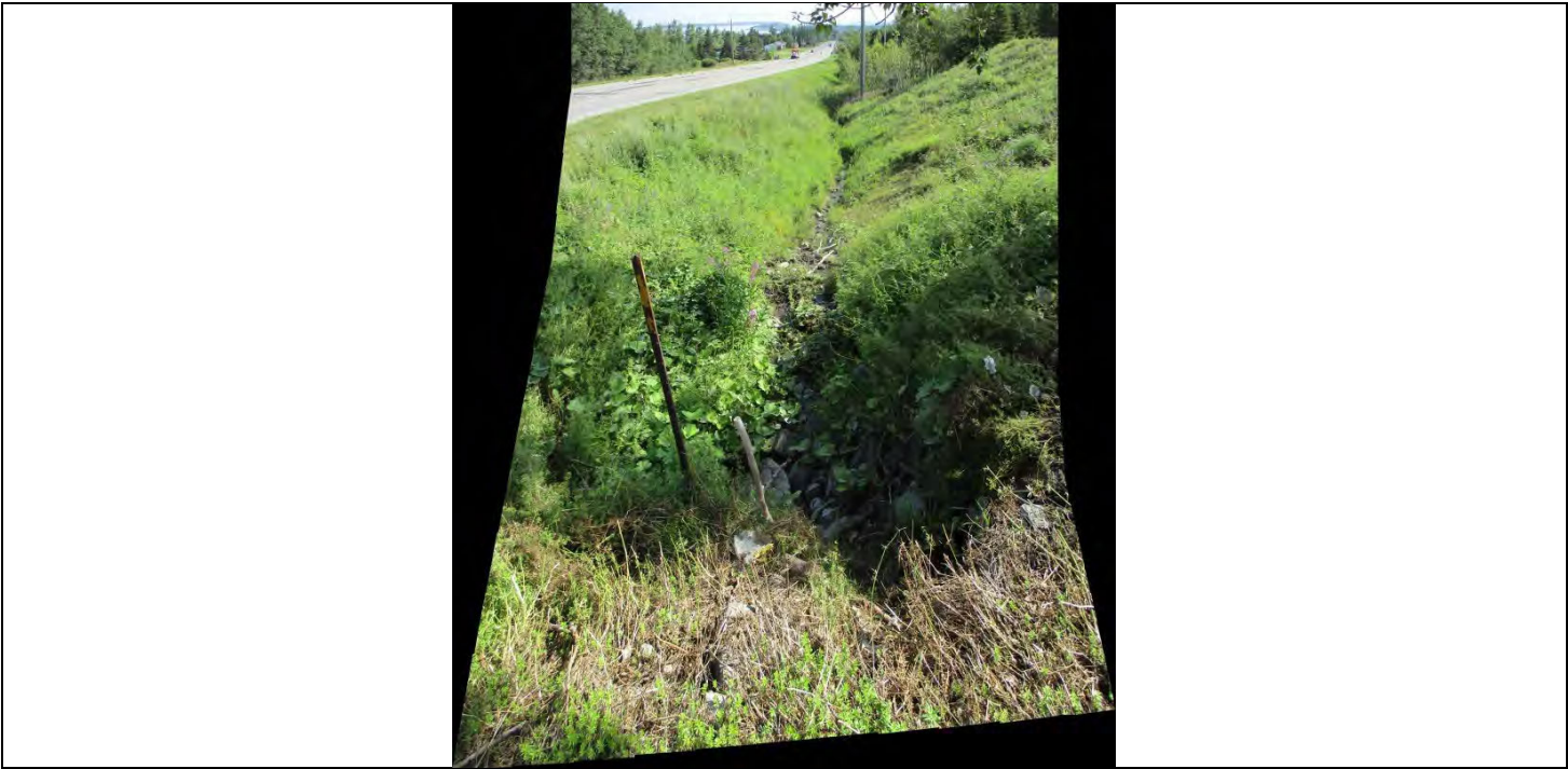
Fusion IMG_2755-2756-2757.jpg Image 31: L'eau dans le fossé de route du boulevard Saint-Germain.
